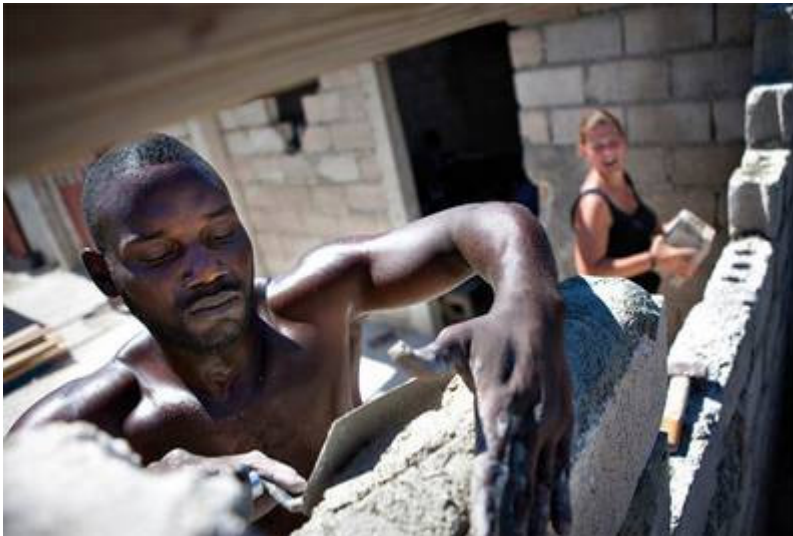
Teamwork: Rebecca und Jhonson setzen neue Mauersteine in der Emes-Schule (Foto: Jonas Wresch)
